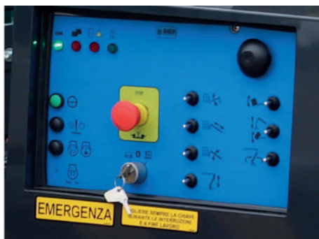
Panneau de contrôle poste bas.
