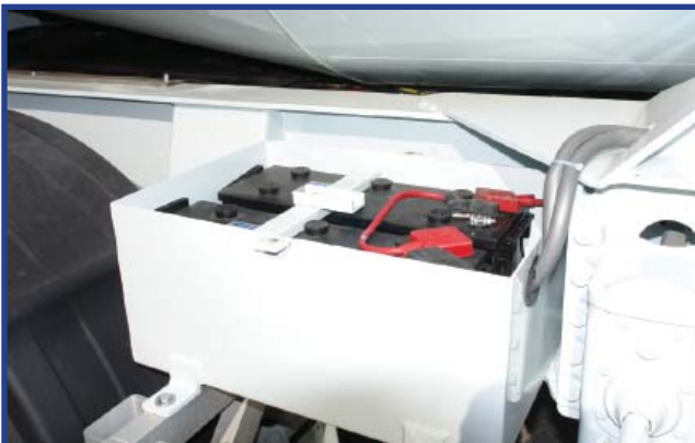
Coffre à batteries
