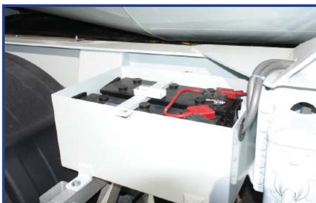
Coffre à batteries
