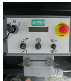
> Boîtier de commande en cabine
